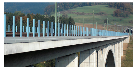
Obr. 7. Protihlukové stěny pro Deutsche Bahn
